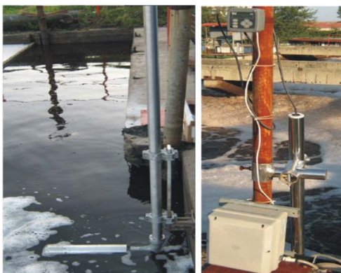
Sistem de control a concentrației de oxigen într-o instalație de tratare a apei.
